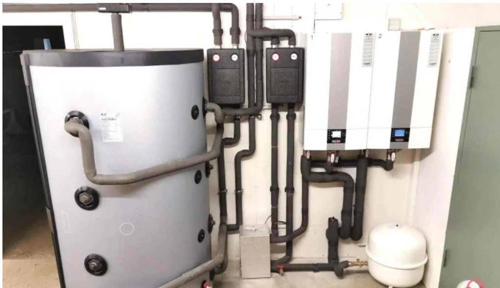
Heizung sanitar rottmerhusen tonning alle
