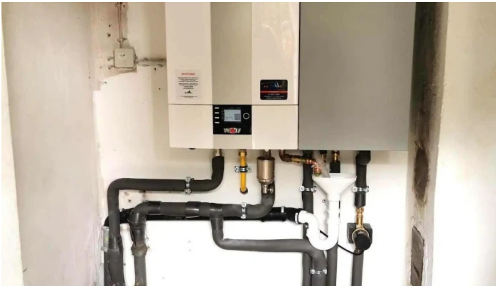
Heizung sanitar rottmerhusen tonning maschine
