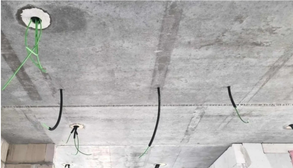
Trp technik elektriker
